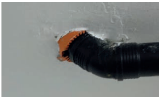
Falsch verbaute Produkte bilden keine Grundlage für den vielzitierten Bestandsschutz.
