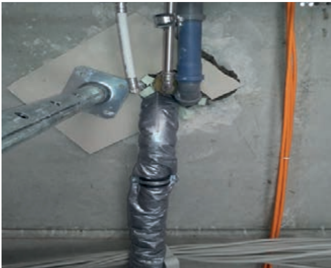
Beispiel unsachgemäßer Sanierungsarbeiten
